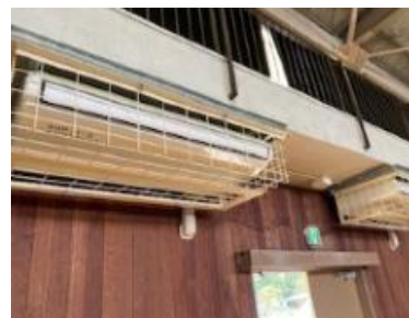
【計8台のエアコンが設置!】
