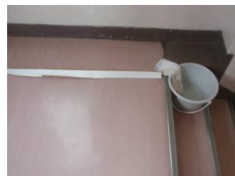
教室棟4階の雨水侵入
